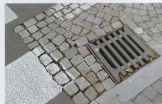
Obr. 4 – Stav kostek po půl roce letního provozu (betonárkou namíchaná směs)
