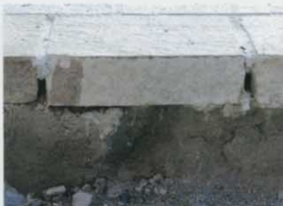
Obr. 5 – Nedostatečné zatečení směsi (byť XF4) z betonárky
